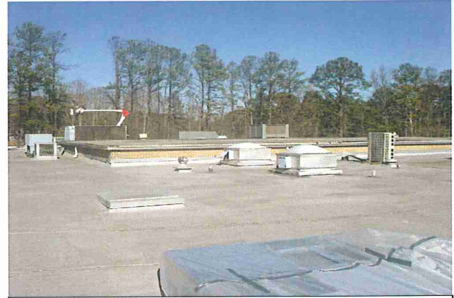
Dunaire ES Roof Top Units
