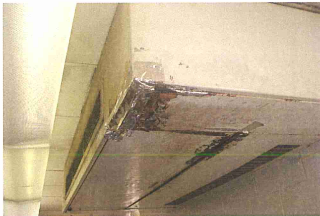
Redan ES Existing HVAC Unit
