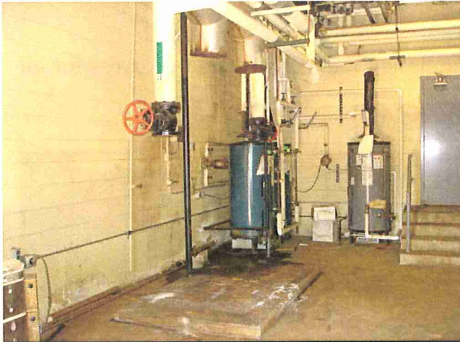
Avondale ES Existing Boiler Room
