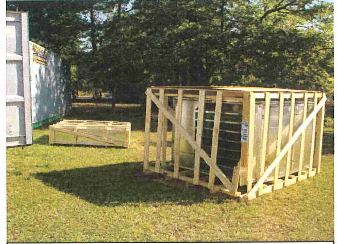
Avondale ES New Roof Top Unit
